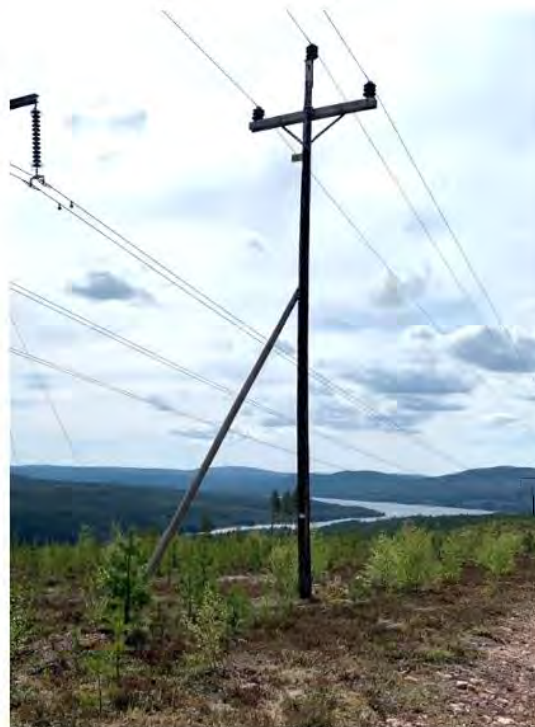
Figur 5. Enkelstolpe tillhörande befintlig 72,5 kV ledning L154. Fasavstånd cirka 2 meter.
