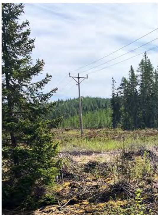
Figur 4. Enkelstolpe tillhörande befintlig 72,5 kV ledning L154. Fasavstånd cirka 1,3 meter.
