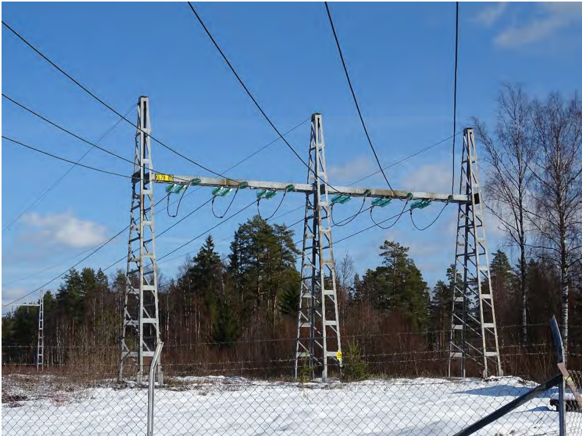
Figur 3. Fotot visar stolpkonstruktionen för aktuell dubbelledning. En sambyggd trebent stolpe med överliggande regel håller upp två 50 kV ledningar. Dubbelledningar har totalt sex faslinor. Stolpen i fotot är en vinkelstolpe, men även raklinjestolparna har tre ben.
