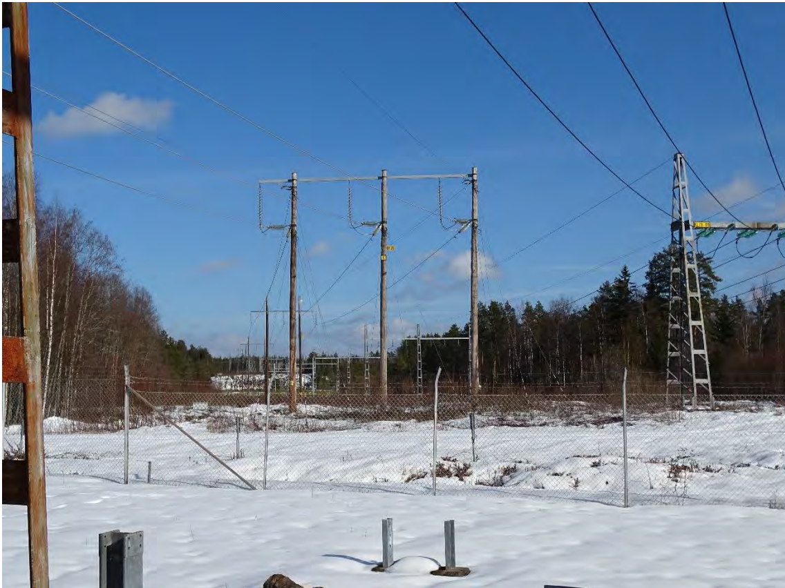
Figur 4. Till höger i bilden syns aktuell 50 kV dubbelledning med stålstolpar, och till vänster syns parallellgående 130 kV ledning.
