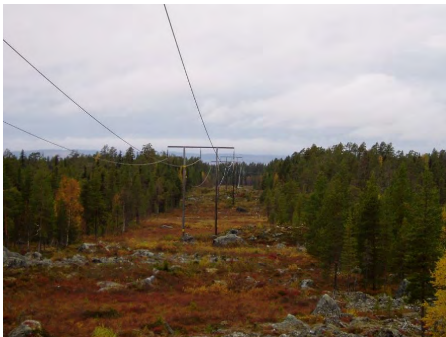
Figur 1. 130 kV luftledning i regionnätet, trädsäker.
