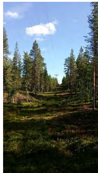
Figur 2. 20 kV luftledning i lokalnätet, ej trädsäker.
