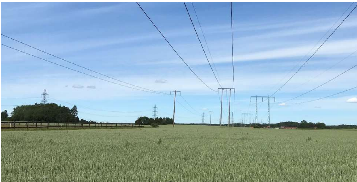
Figur 6. Befintliga ledningar vid Fjällsta, vy mot norr. Från vänster till höger: Svenska kraftnäts sambyggda 220/400 kV-ledningar (KL42 S4-7/CL6 S6-8), Trafikverkets matarledning (JL7 S5), Vattenfall Eldistribution ABs befintliga 70 kV-ledning (ÅL9 S2) samt Svenska kraftnäts 220 kV-ledning (KL42 S8) som idag matar Måby station. Samtliga ledningar omfattas av kommande ledningsåtgärder.
