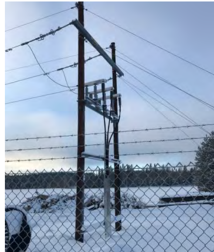
Figur 8. Exempelbild på en kabelstolpe.
