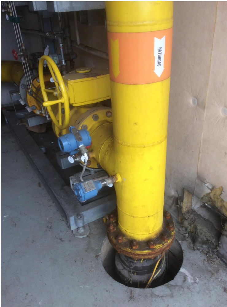
Bild 3.2: Utgående linjer 4 bar m isolerkoppling placerad i golvgenomföring. Torrt markförbindelse.
