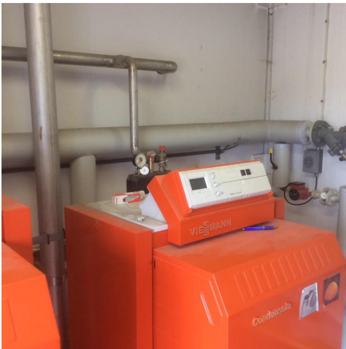
Bild 1.4: Gaspannor från 1997, utbyte är planerat till 2018/-19
