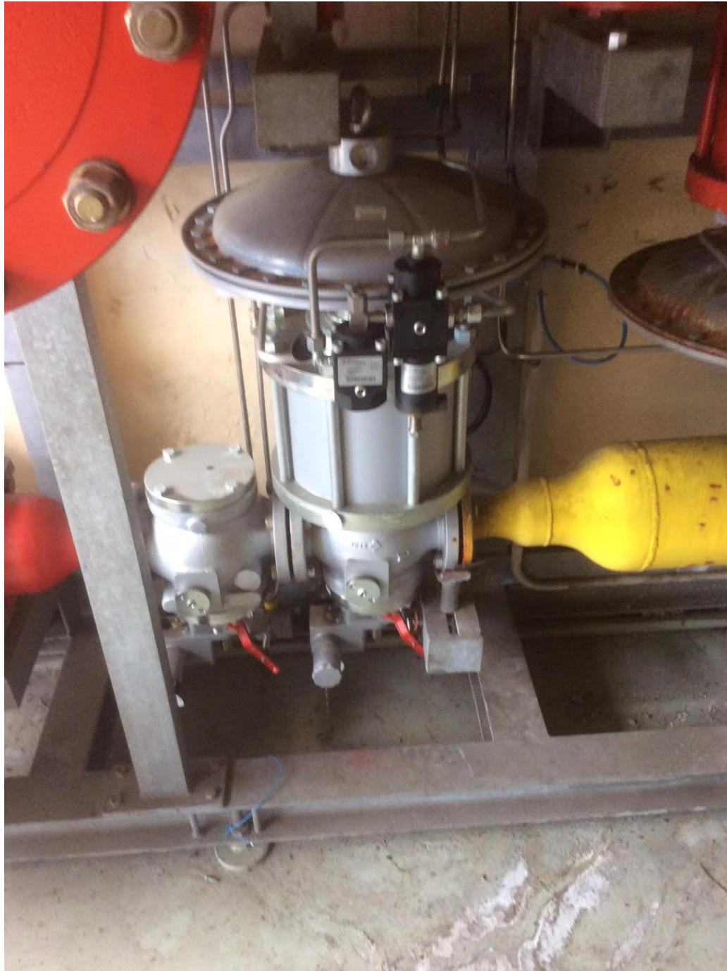
Bild 3.3: Reducerlinje nr 1, 16 till 4 bar, nyligen utbytt. Regulator typ Fiorentini med framföreställd SSV.
