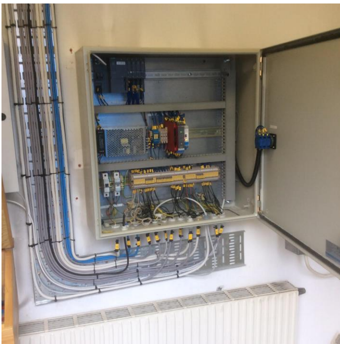
Bild 2.2: Elinstallation, styr o regler placerat i separat utrymme
