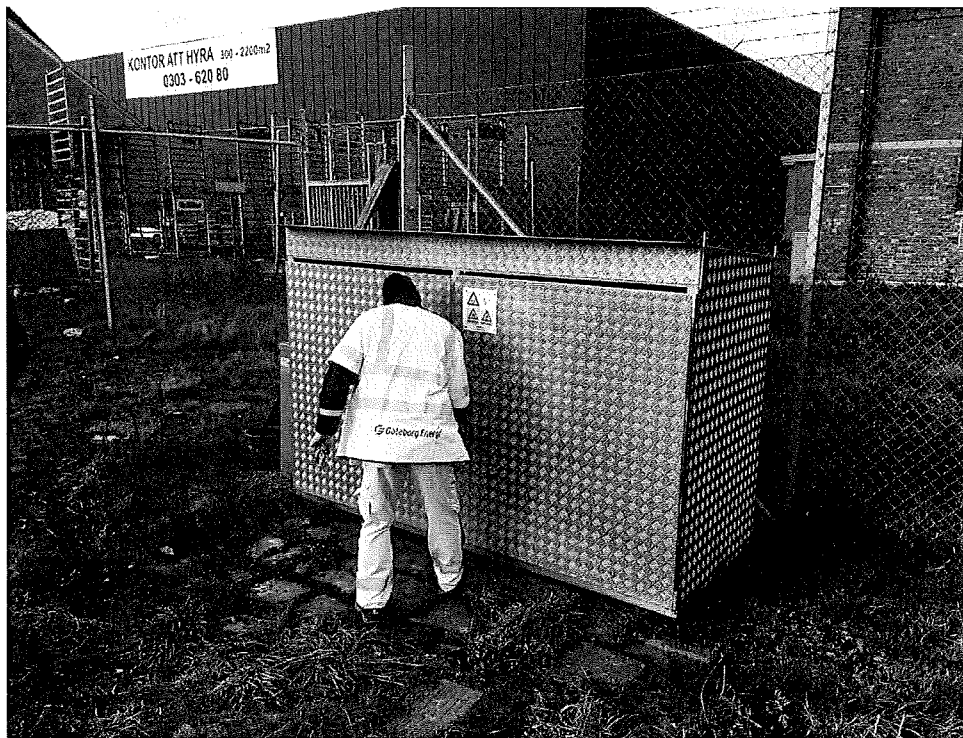
Bild 5:1: Reglerstationen är placerad i en grönyta intill ett industriområde nära väg med tät trafik.
