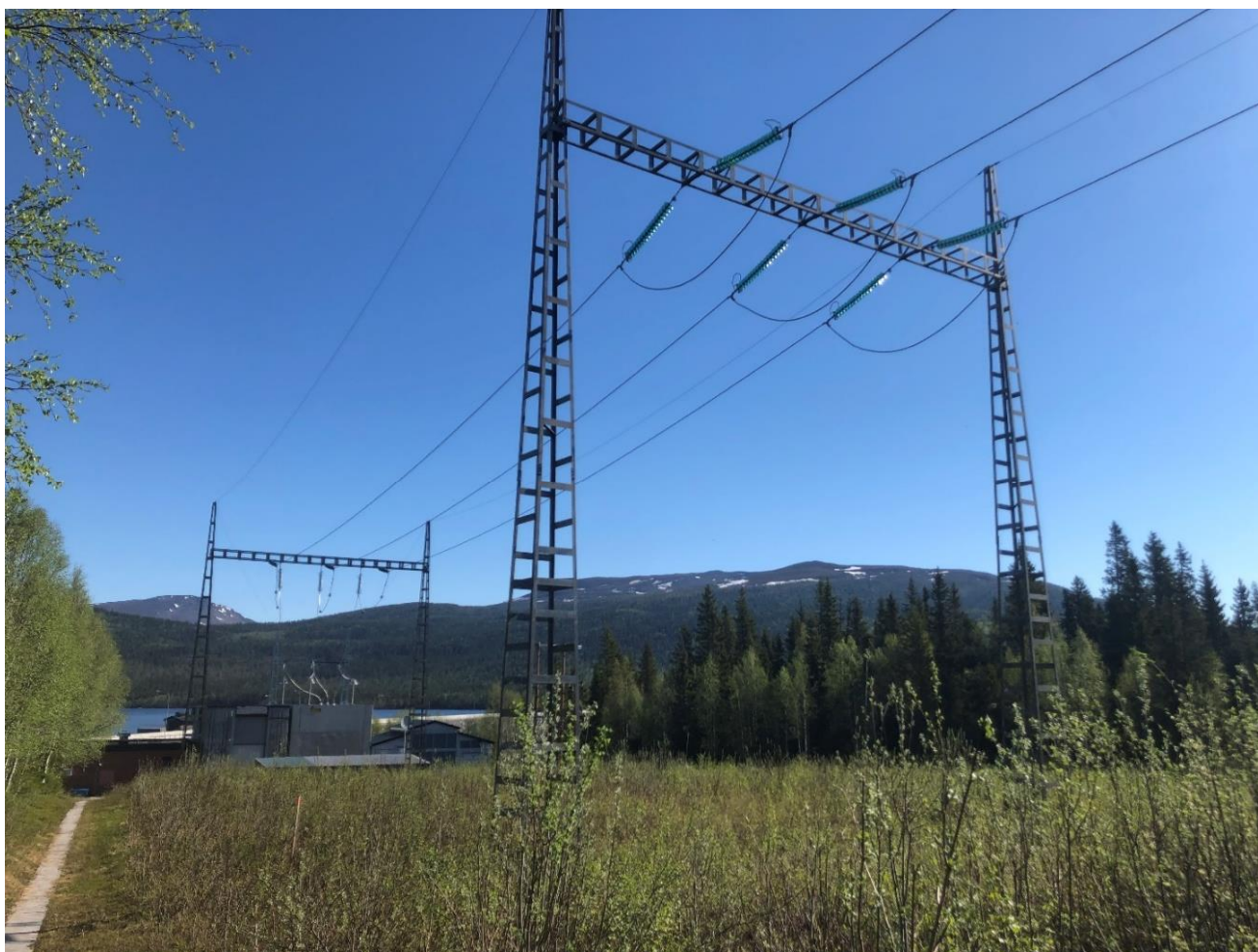
Figur 8. Foto på befintligt luftledningsspann.
