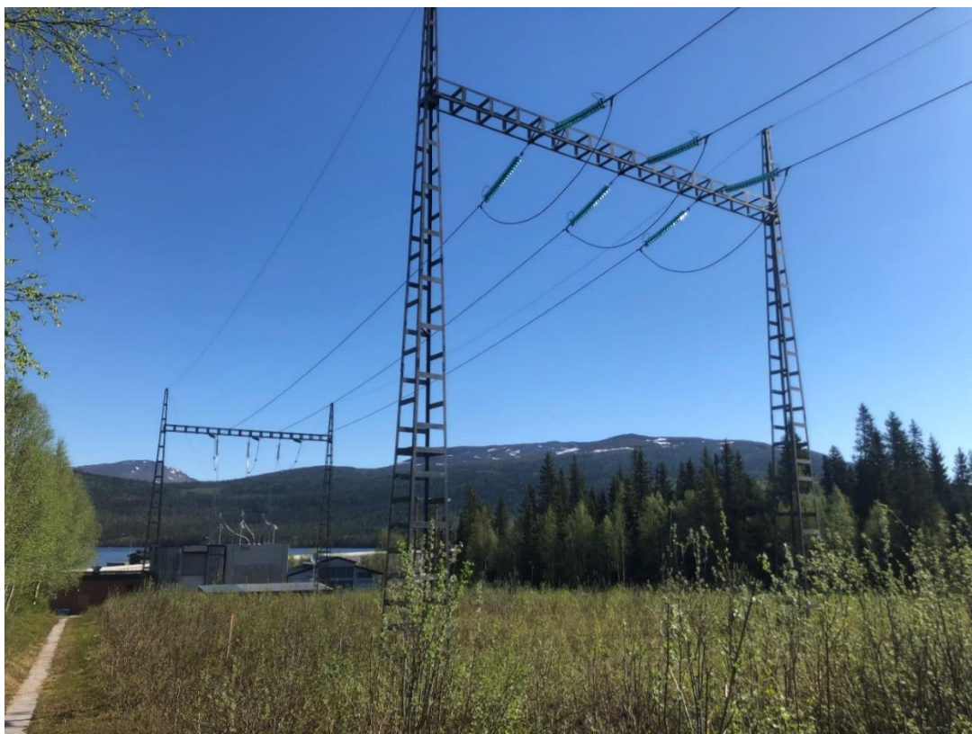
Figur 3. Befintligt luftledningsspann. Bilden är tagen mot norr.
