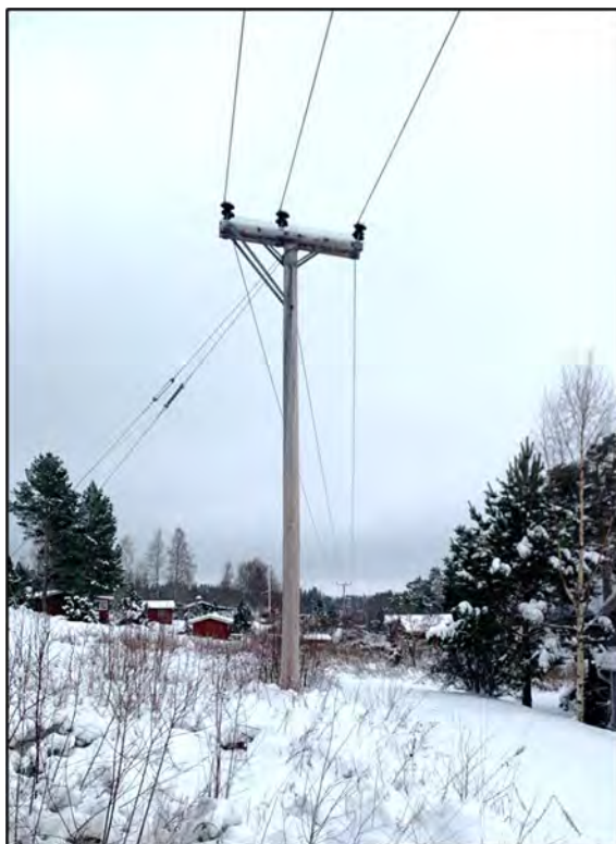
Figur 2. Enkelstolpe tillhörande AL12S1.
