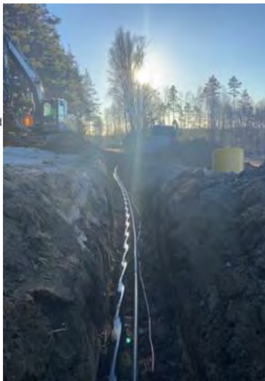
Figur 4 Exempel på ett kabelschakt för 36 kV markförlagd kabel. N.b. på bilden ligger även ytterligare fiberslang och jordlina.
