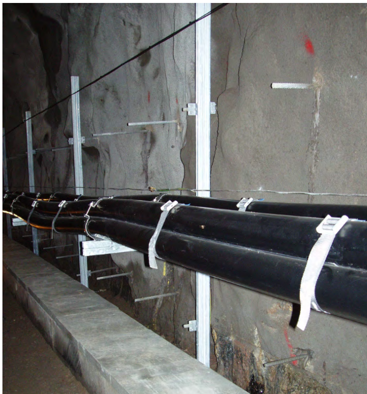
Figur 5.2. Foto av motsvarande kabelförband i en tunnel.
