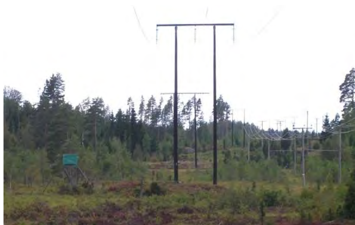
Figur 3. Exempel på portalstolpe av trä där ledningen BL7 S8 passerar Torsmossen. Till höger i bild syns två parallellgående 40 kV ledningarna samt en 12 kV ledning
