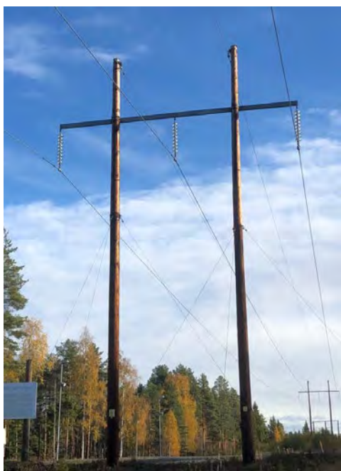
Figur 3-1. Exempel på en träportalstolpe med faslinor i horisontalplan och två topplinor.
