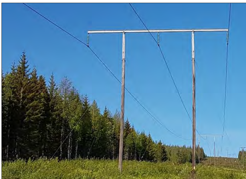
Figur 3-1. Exempel på en träportalstolpe med faslinor i horisontalplan. Ledningen på bilden har inte topplina.
