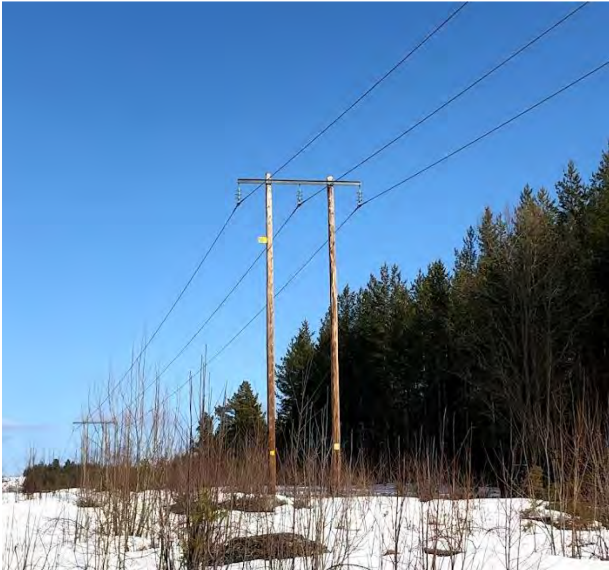
Figur 4. 40 kV ledning, portalstolpsutförande, i träsåker skogsgata
