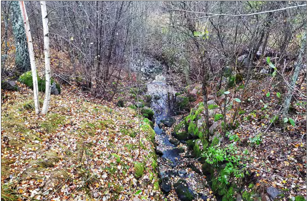
Figur 24. Utloppet från Dammsjön är reglerat genom en damm av betong med manuellt reglerbar dammlucka. Nedanför dammen styrs bäcken av en äldre kallmurad kantmur.
