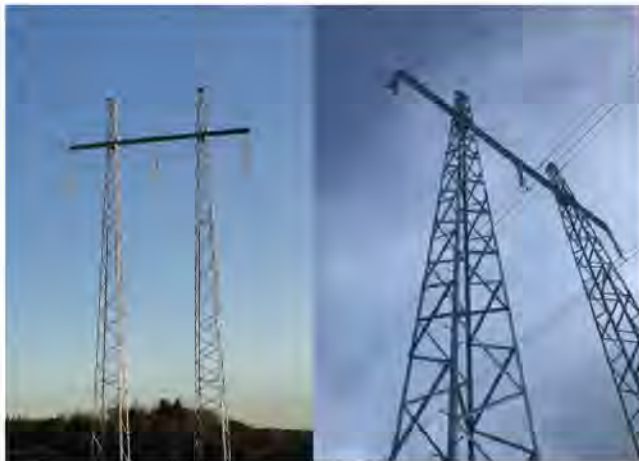
Figur 2.6. Exempel på stolptyp som skulle kunna bli aktuell i projektet. Bilderna är tagna på en av Svenska kraftnäts 220 kV-ledningar i Ljusdal som nyligen förnyats. Notera att ledningen har två faslinor per fas till skillnad från aktuell ledningsförnyelse som planeras ha en faslina per fas.
