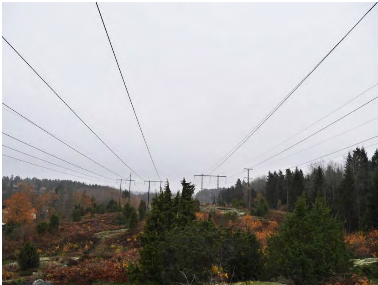
Figur 2. Översikt över befintliga ledningar i nuvarande ledningsgata, väster om Viby. Från vänster ses Vattenfall Eldistributions två 70 kV ledningar. Därefter kommer Svenska kraftnäts 220 kV ledning och längst till höger Trafikverkets 65 kV ledning.
