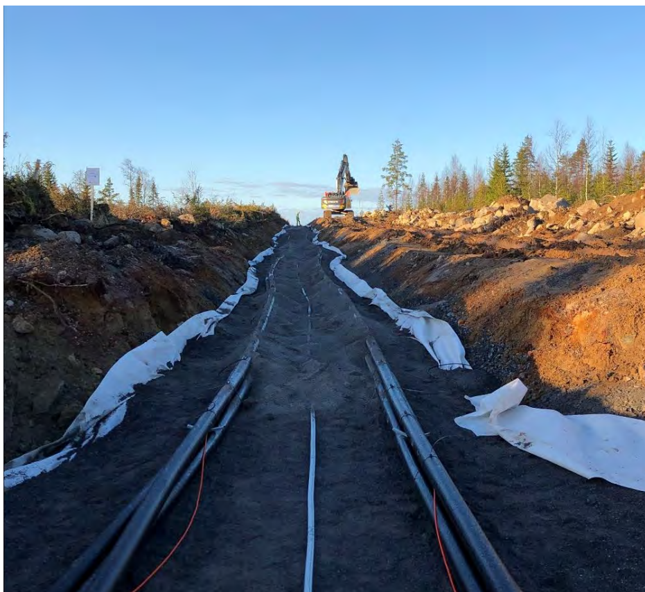
Figur 9. Exempel på markkabelförläggning av 145 kV.
