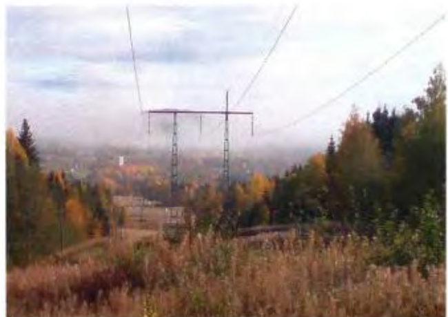
Figur 4.4 Portalstolpe av stål, bilden tagen mot öster, Hammarstrand skymtas i bakgrunden.
