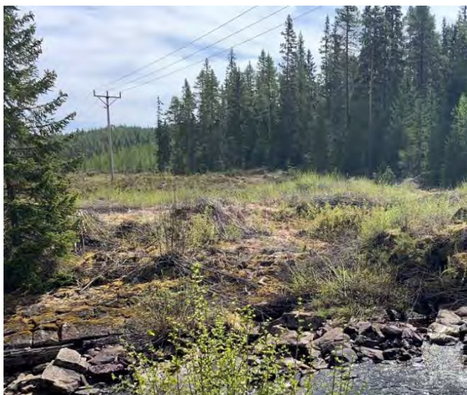
Figur 5. Enkelstolpe tillhörande befintlig 72,5 kV ledning L184.
