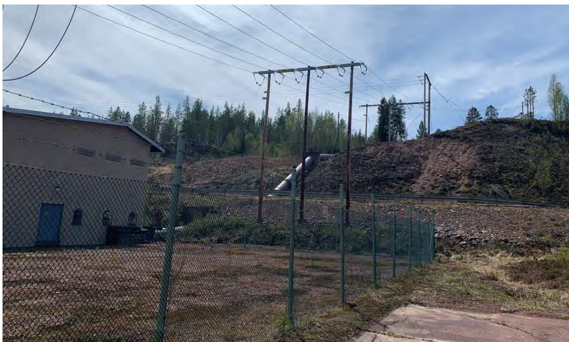
Figur 2. Befintlig luftledning L184 där den går ut från station Ugsiås transformatorstation.
