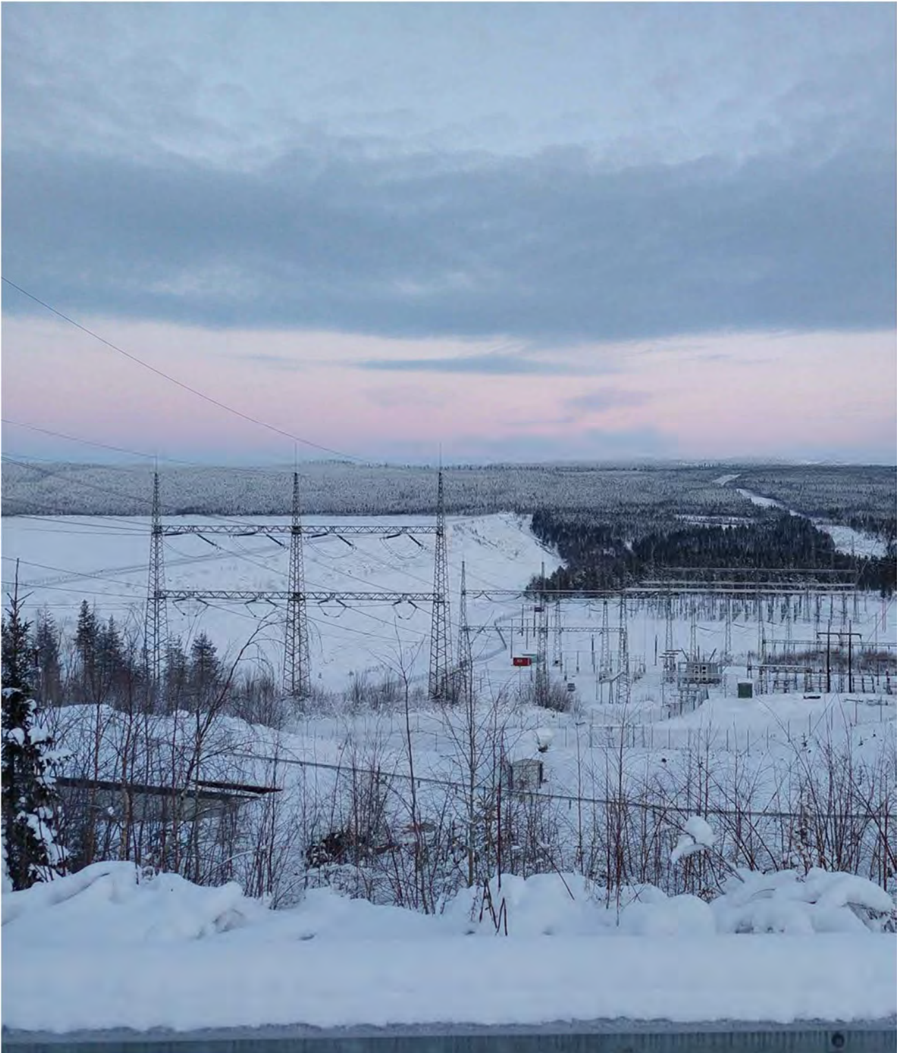
Figur 3. Foto över det nedre ställverket sett från vägen. Den närmaste stolpen i bild är stolpe nr 4, som står utanför inhägnat område. Fotograf [REDACTED]
