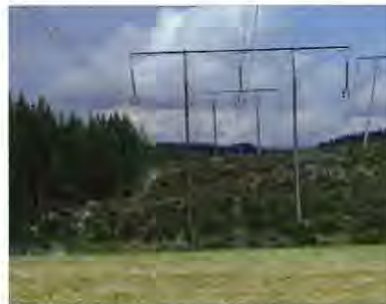
Figur 6.2. Ledningen strax väster om Lumsheden.
