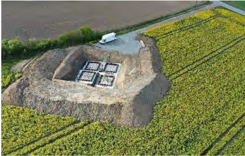
Figur 14. Fundamentgrop för en stubbe (vinkelstolpe) på jordbruksmark med tillhörande arbetsväg. Arbetsområdet kring stolpen återställs efter att stolpen är färdigbyggd.
