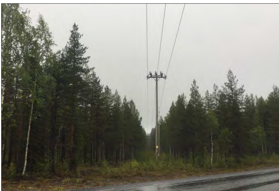
Figur 3-1. Foto på luftledningen mellan US28 vid Strömfors och station US22.
