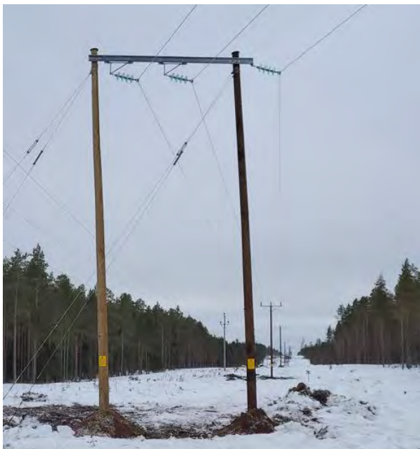
Figur 7.2. Exempel på 40 kV parstolpe vinkel. Foto: PiteEnergi Elnät
