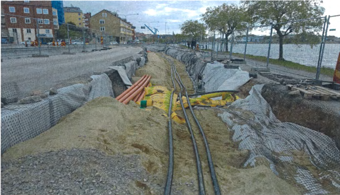
Figur 3 Kabelschakt markförlagd kabel med ett förband i samförläggning med annan infrastruktur
